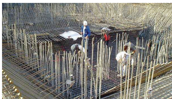
Fundamentplatte mit Absorberleitungen
